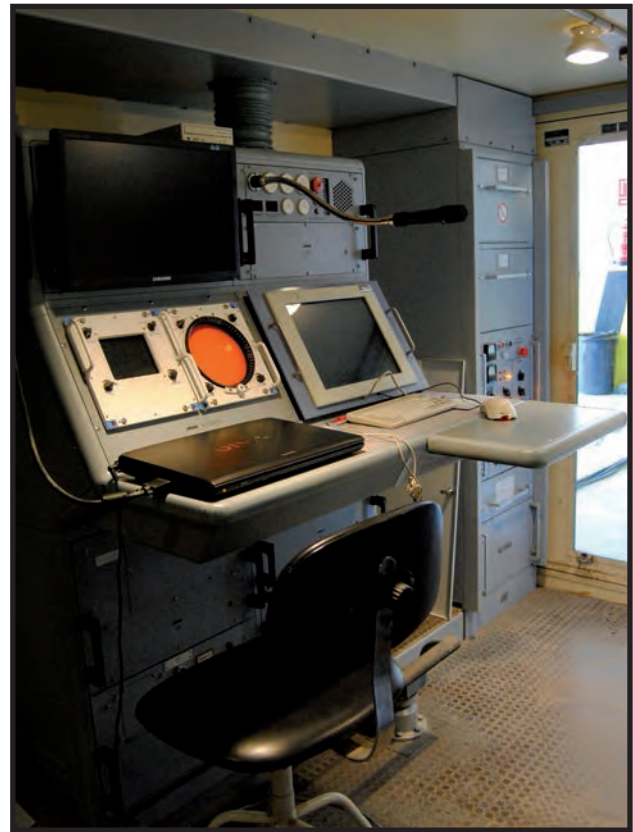
Panel de mando y control
